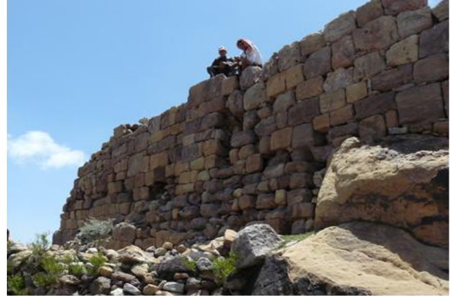
شكل (45): واجهة خراب القصر الشمالية بالمنصورة
